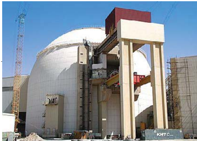
نیروگاه اتمی بوشهر
