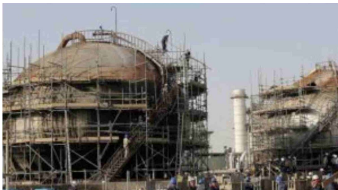
کارگران در حال تعمیر پالایشگاه آرامکو پس از حمله ۱۴ سپتامبر در «بقیق»
